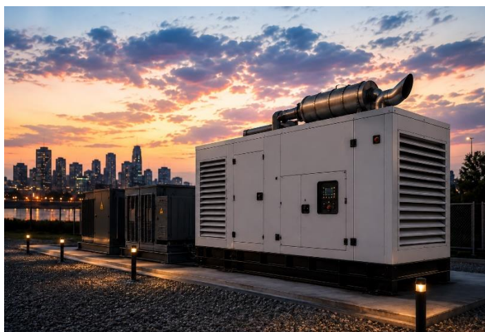
Máy phát điện
